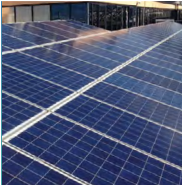
Από την εγκατάσταση των φωτοβολταϊκών πάνελ στην ταράτσα του κεντρικού κτηρίου του Ομίλου
